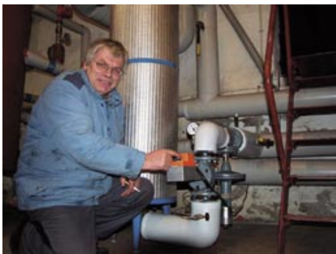
Varmemester Flemming Thiemke skal ikke foretage reguleringer på varmeanlægget. Det kører fuldautomatisk efter udetemperatur og efter 4 årstidsprogrammer.
