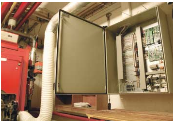
Ved oliefyret er der anbragt en CTS-tavle med en Clorius ISC 5000 understation.
