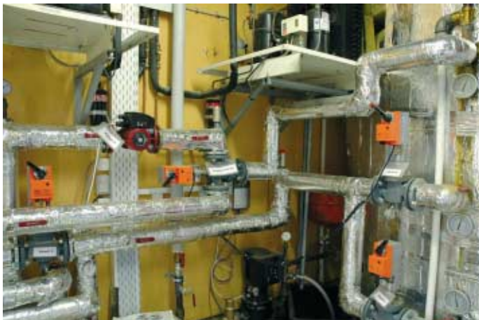
Ved solvarmeanlæggets akkumuleringstank er der følere og motorventiler, som styrer vandstrømmen i forhold til den aktuelle effekt fra anlægget.
