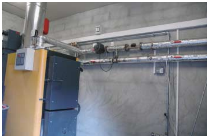
Pillefyret er den primære varmekilde om vinteren.
