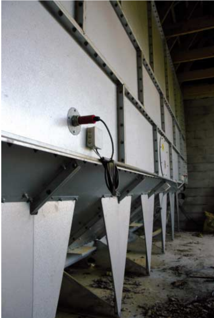
Der bruges 110 – 120 tons træpiller om året på Den Rytmiske Højskole. Via en niveauføler gives der signal på CTS-anlægget, når det er tiden at bestille et nyt læs brændsel.
